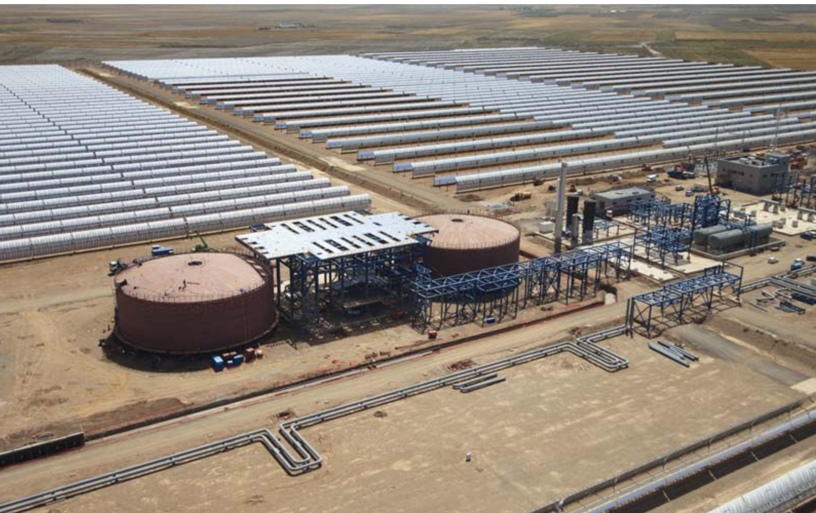
El complejo termosolar de Andasol , en Granada, almacena el calor generado durante las horas de luz en depósitos de sal fundida ( marrón ). Durante la noche, esta se emplea para generar energía eléctrica.
